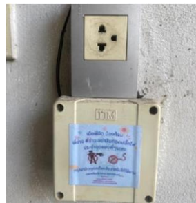
ภาพที่ 5 ตัวอย่างจุดที่ติดป้ายสติ๊กเกอร์รณรงค์การประหยัดพลังงานไฟฟ้า
