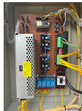
ข. ด้านในตู้ควบคุม
